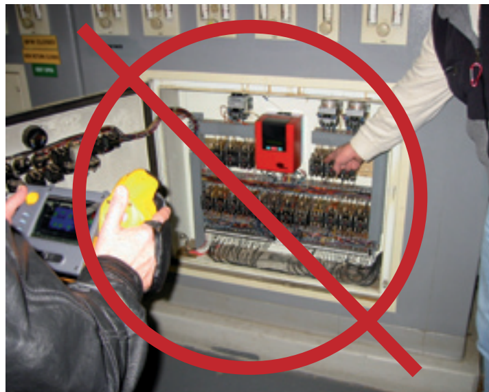
IR-Fusion исключает опасную практику, связанную с указанием пальцем перегревающегося компонента в электрошкафу.
